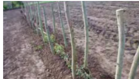
Construction d'une fascine © Agence de l'eau Artois Picardie - Chambres d'Agriculture des Hauts-de-France - SOMEA
