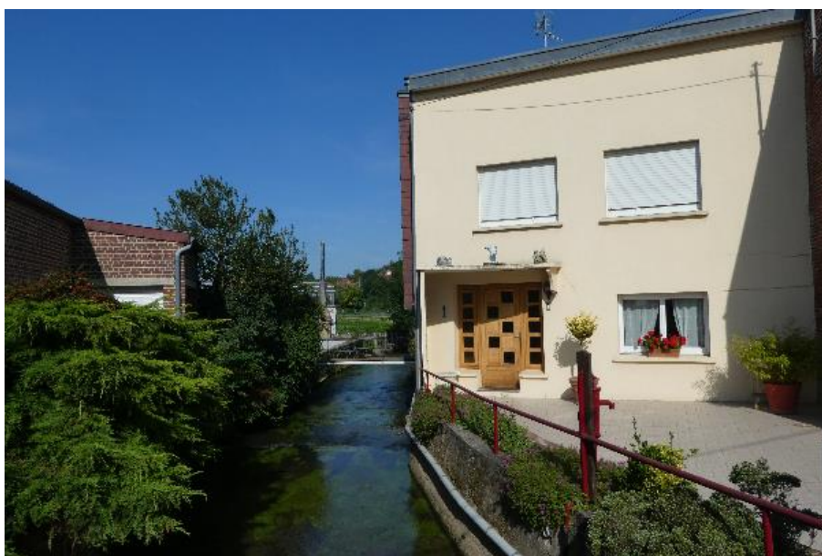
Maisons fissurées en bordure de Rhonelle
