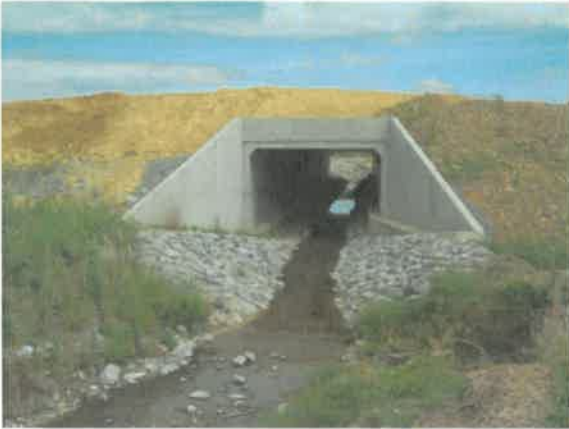
Figure 38: Exemple de protection des berges par enrochement aux abords d'un ouvrage hydraulique
