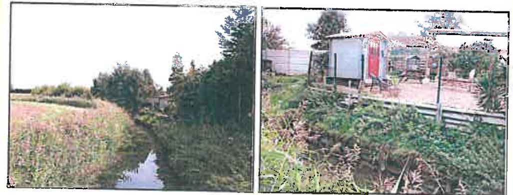
Le remblaiement de la berge provoque la déstabilisation de celle-ci. Le tunage bois existant est détérioré.
