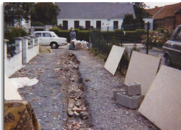
Domages dans les ruelles de Vertain, a priori des écoulements dans les anciens chenaux des Harpies transformés en ruelles au fil du temps
