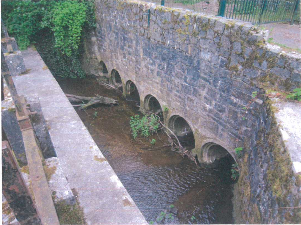
Anor - Barrage de la Galoperie - Vue amont des buses de l'ouvrage hydraulique
