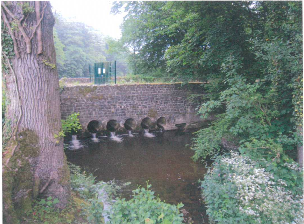
Anor - Barrage de la Galoperie - Vue aval des buses de l'ouvrage hydraulique
