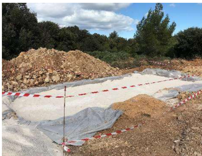
Figure 38 : Fouille préparée pour la pose d'un poste de conversion/transformation (Source : EDF Renouvelables)
