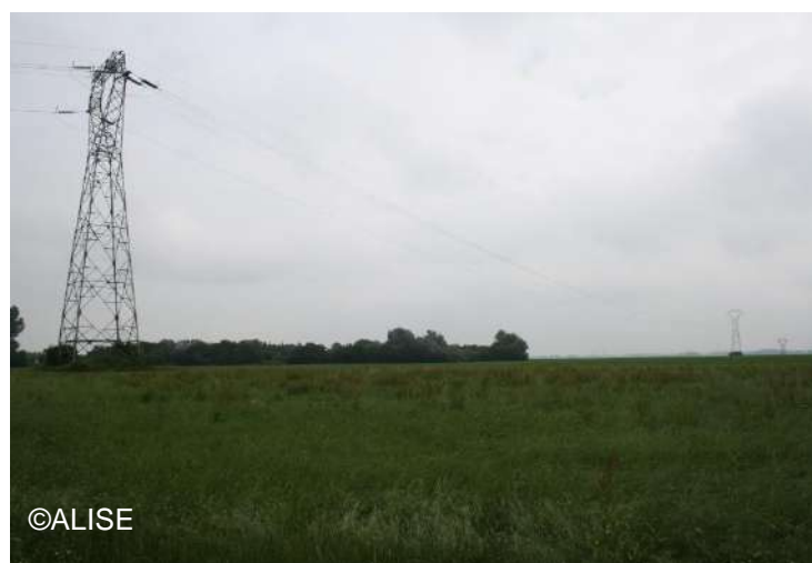
Photo 25 : Ligne RTE à l'est de la zone d'étude
