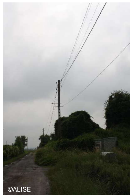
Photo 24 : Ligne Enedis aérienne au nord de la zone d'étude
