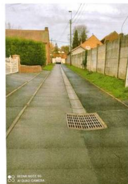
Photo 3 : avaloir environ 90x90 cm, profondeur environ 1,50 CC1 dirigeant & EP de voirie.
