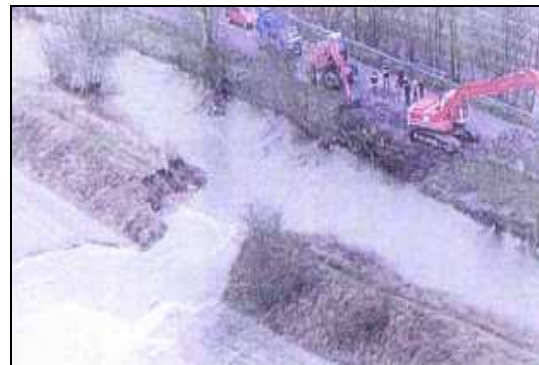
Rupture d'une digue dans le secteur de Thivencelle (Février 2002)
