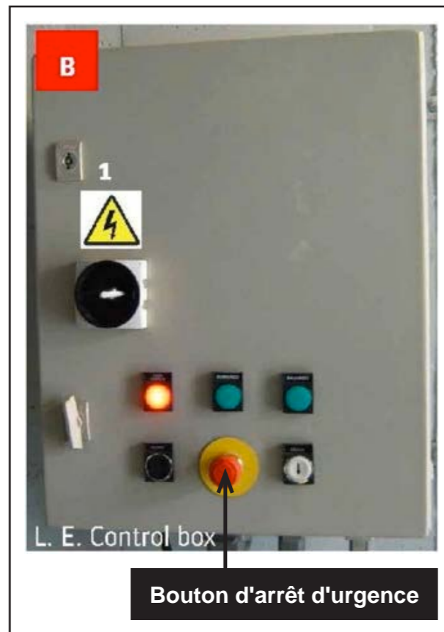
Figure 129 : Bouton d'arrêt d'urgence sur la boîte de contrôle de la nacelle
