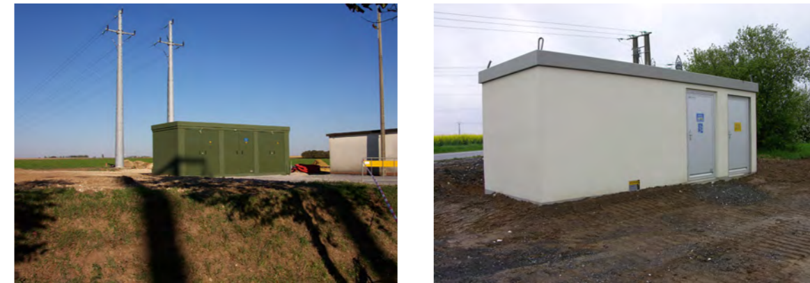
Photographie 1 : Exemples de postes de livraison
