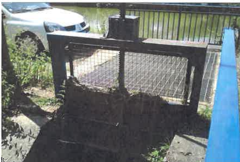
Figure 27: photo vanne côté canal de la prise de Bois l'Abbaye (rapport de stage 2011 C. Demol)
