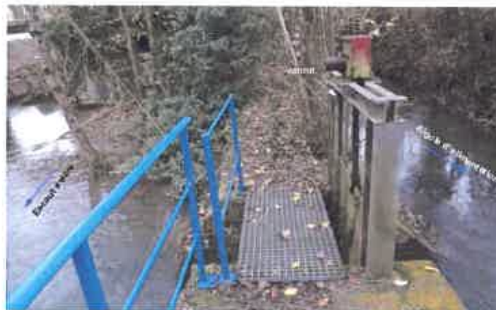
Fig.12 : Prise d'eau de Vinchy -- vanne bord à Escaut rivière
