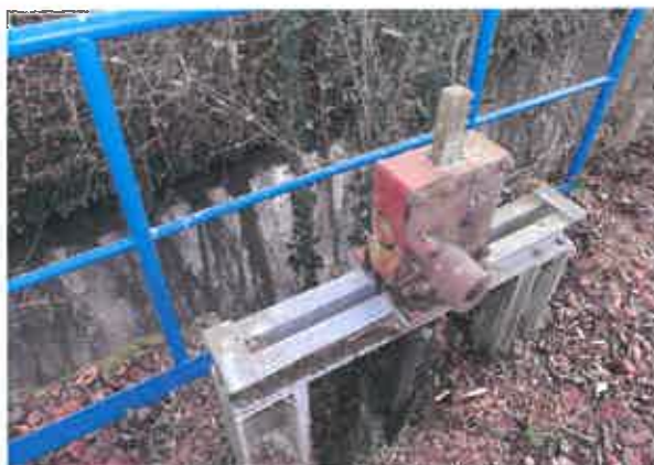
Fig.15 : Vanne de décharge fermée
