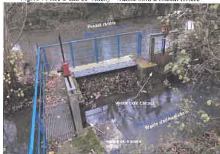
Fig.13 : Vue d'ensemble de la prise d'eau de Vinchy
