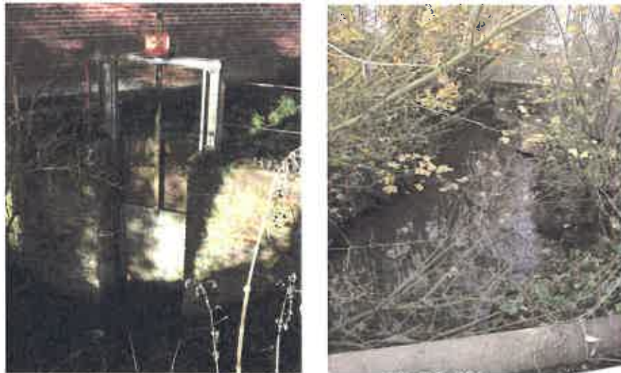
Fig.11: Vanne ouverte sur rigole d'alimentation et vue de la rigole d'alimentation
