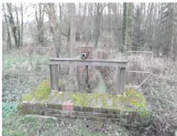
Fig.20 : Vanne de décharge
