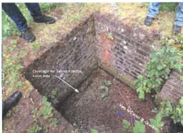
Fig.12: Prise d'eau de Talma-Source condamnée
