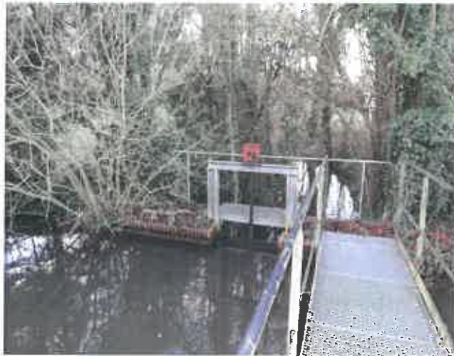
Fig.13 : Vanne de décharge vue de la rigole d'alimentation
