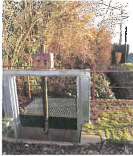
Fig.13 : Vanne 2 – vanne de prise d'eau
