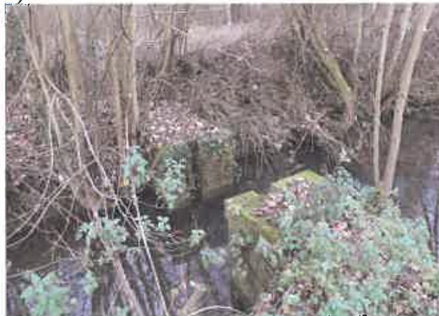
Fig.21 : Vanne d'alimentation abandonnée
