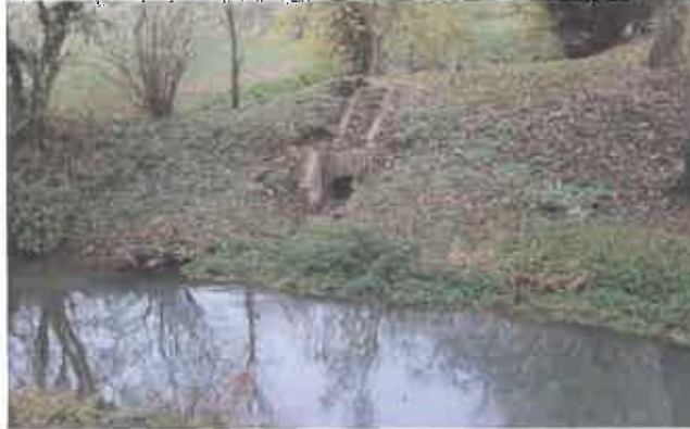
Fig.20 : Vanne d'alimentation abandonnée
