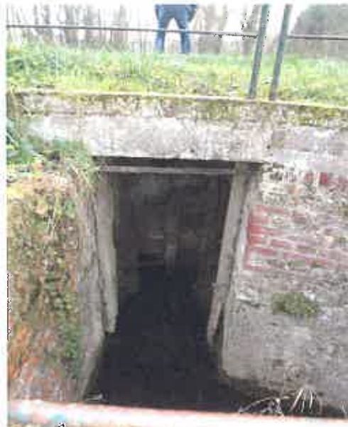
Fig.11 : Vanne de décharge abandonnée
