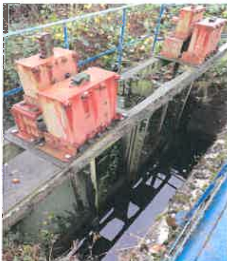
Fig.23 : Vanne de décharge en amont de l'écluse du Bosquet
