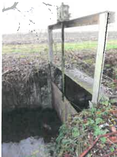
Fig.23 : Vanne d'alimentation en aval de l'écluse du Bosquet
