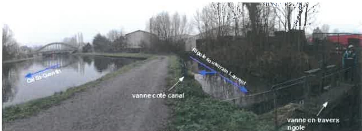
Fig.14 : Vue d'ensemble de la prise d'eau de Honnecourt
