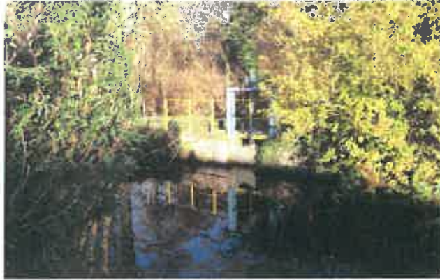
Fig.13 : Vanne de décharge vue de la rigole d'alimentation
