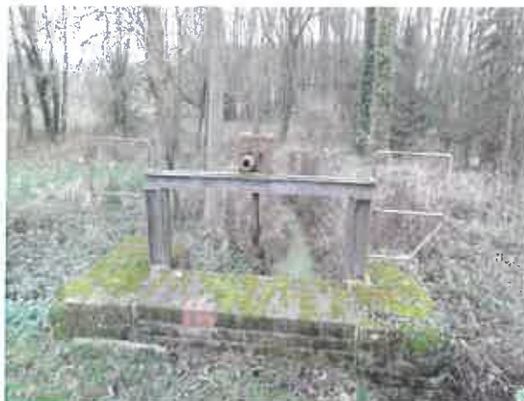
Fig.20 : Vanne de décharge
