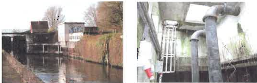
Fig.10: Local et pompes de Denain
