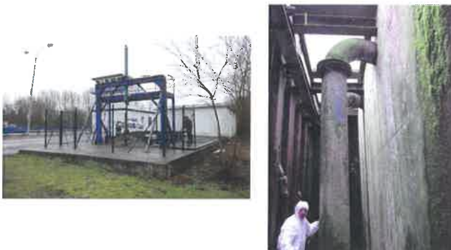
Fig.8:Local et pompes de Pont-Malin
