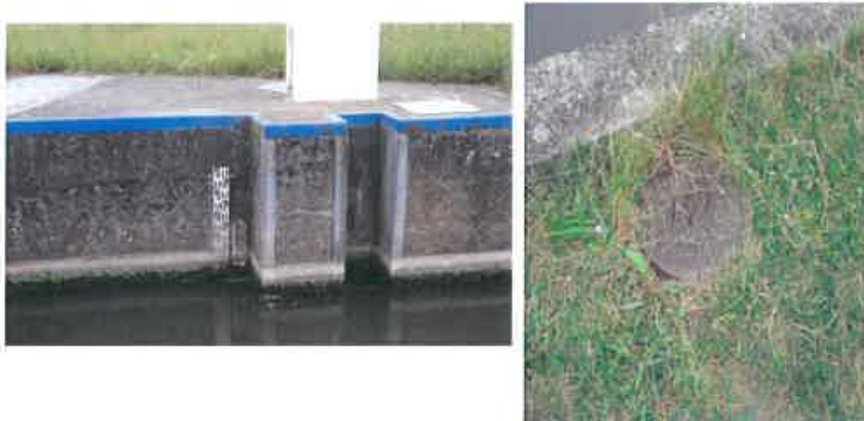
Fig. 20: échelle et sonde amont
