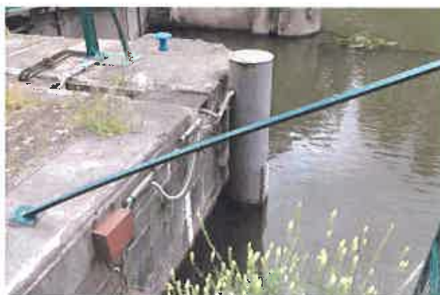
Fig.26 : échelle et sonde amont
