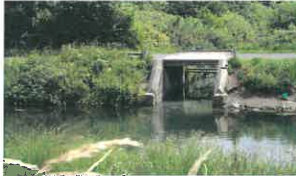
Fig.13 :rejet de la Cunette dans la Scarpe inférieure
