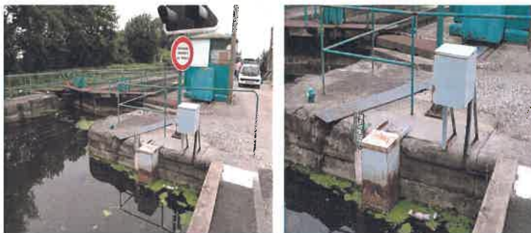
Fig.29 : échelle et sonde amont
