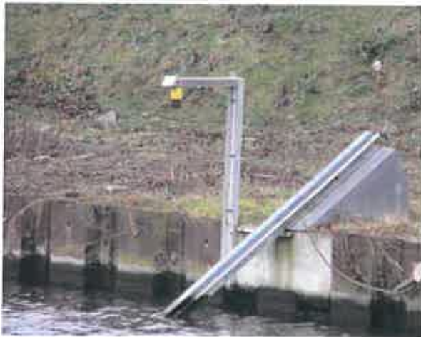
Fig.24 : station débit dans le bras de décharge
