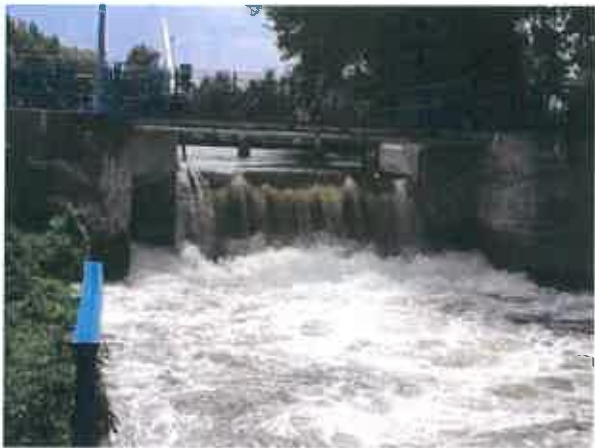
Fig.11 :Photo du clapet ouvert
