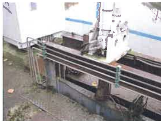
Fig.13 : Aperçu des vannes
