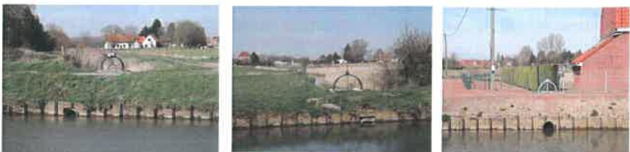
Fig.16 : canalisations de diamètre 400mm « A », « B » et « C » - rejets vers la Lys canalisée
