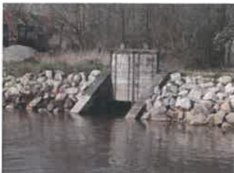
Fig.14 - cadre 3000/3000 – rejet vers la Lys canalisée
