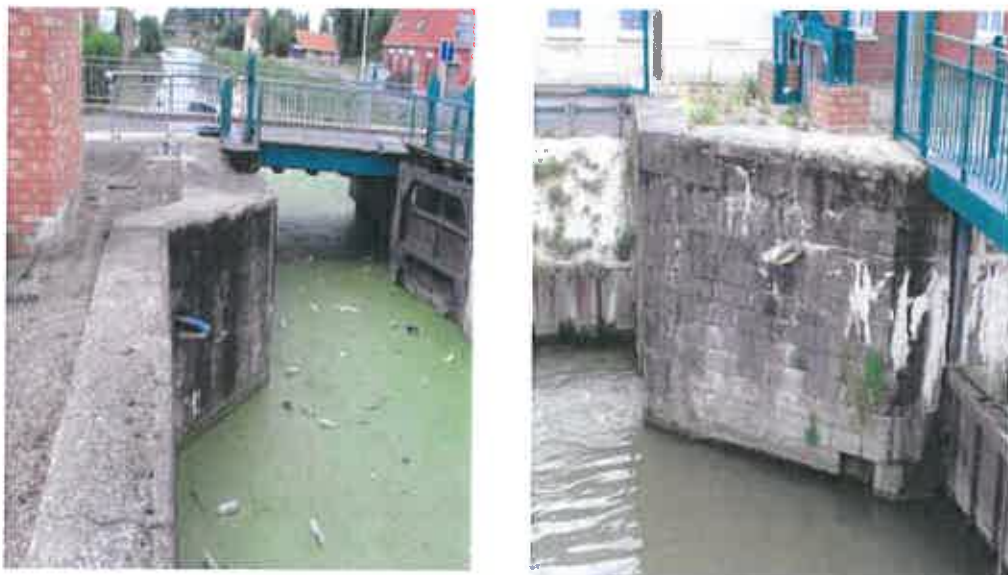
Fig.15 : Vues des sondes amonrt et aval
