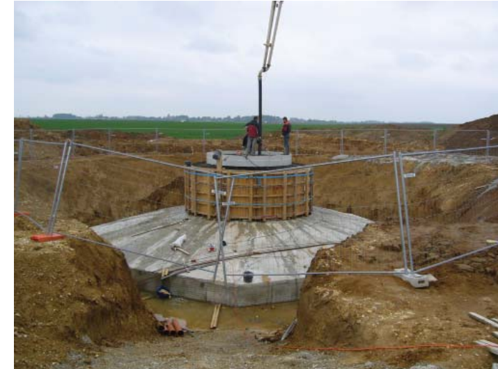
Photographie 15 : Coulage du béton solidarissant la virole, caractéristique des machines de type Vestas, au massif
