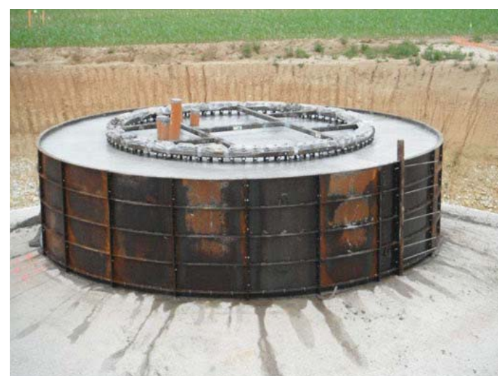
Photographie 13 : Béton solidarissant la caisse d'ancrage, caractéristique des machines Siemens, au massif
