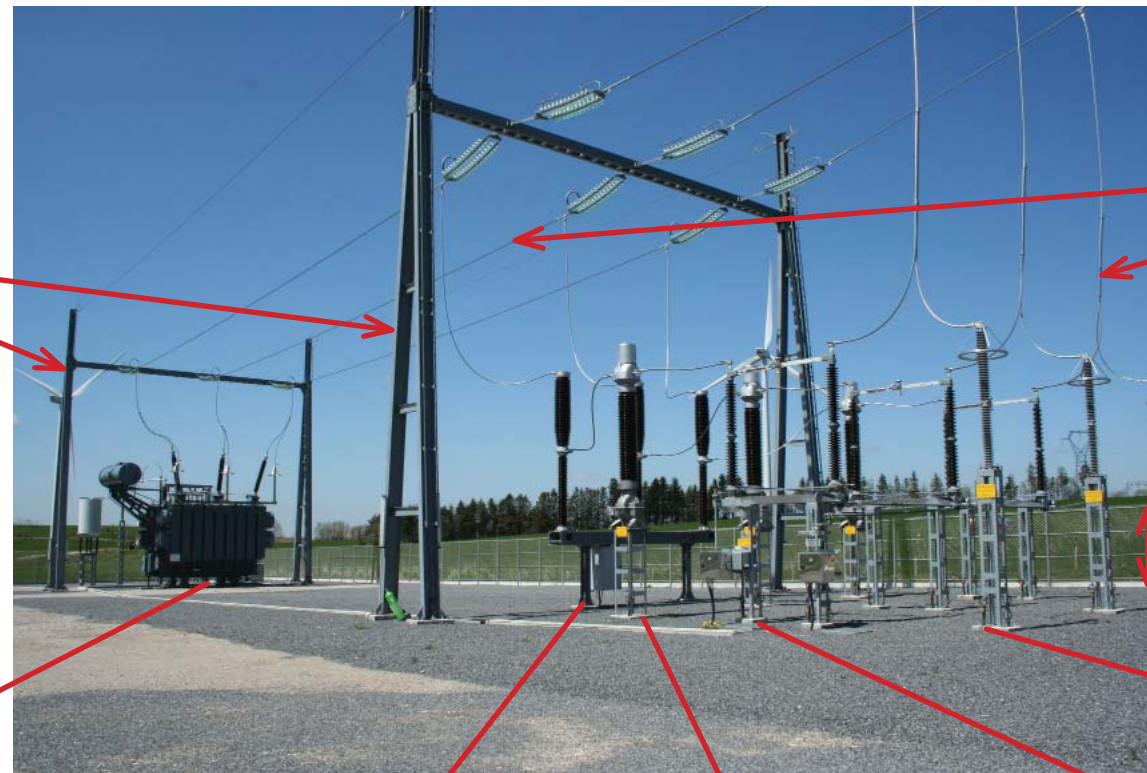
Photographie 3 : Exemple d'un poste de transformation HTB et ses principaux éléments (photographies ECOTERA Développement)
