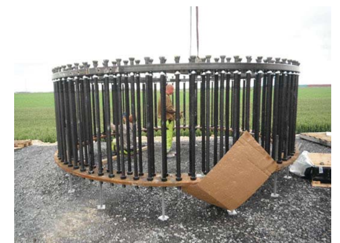
Photographie 17 : Caisse d'ancrage (embase) de l'éolienne stockée de l'aire stabilisée 1
