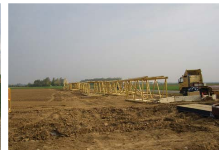
Photographie 25 : Éléments de la flèche d'une grue principale couchés dans une parcelle agricole 1
