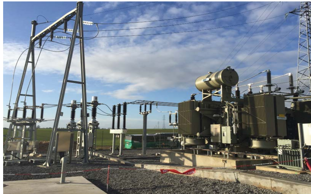
Photographie 2 : Poste de transformation 20/63 kV de Briastre (photographie ECOTERA Développement)
