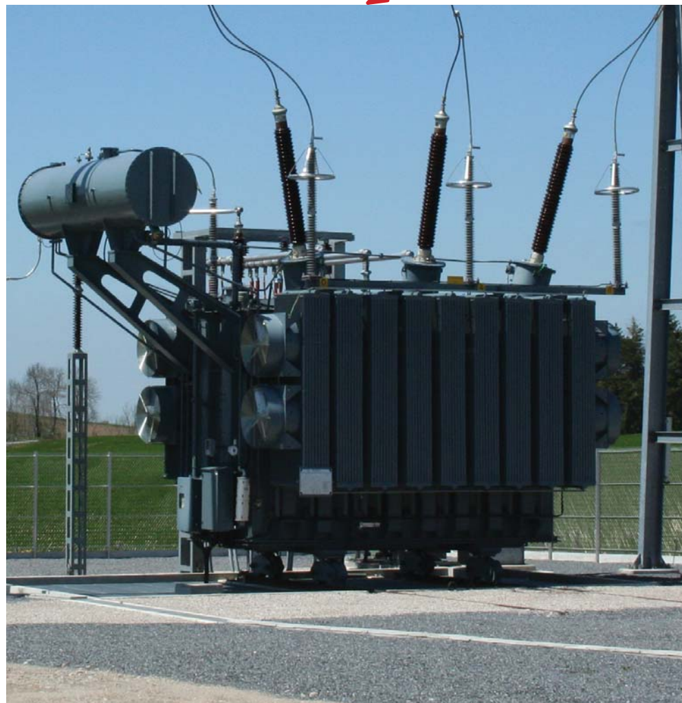
Transformateur de puissance
