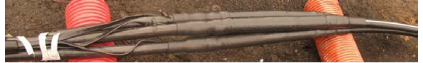
Photographie 32 : Exemple d'une jonction sur système de câbles triphasé (Source : OMEXOM)
