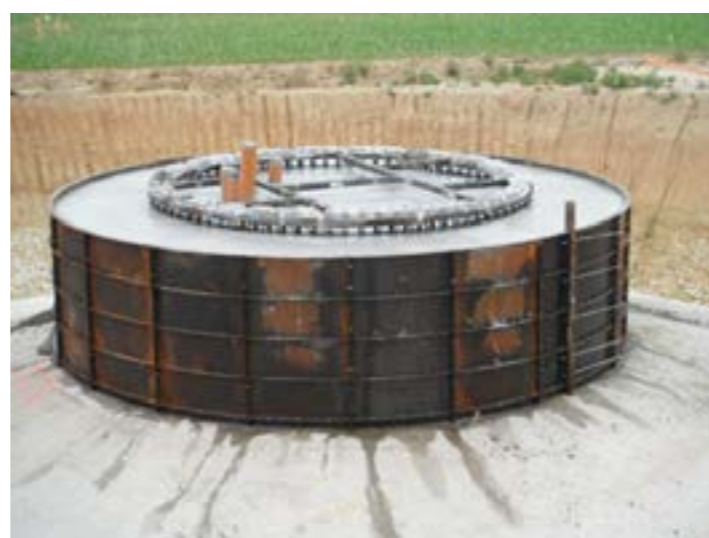
Photographie 17 : Béton solidarissant la caisse d'ancrage, caractéristique des machines Siemens, au massif
