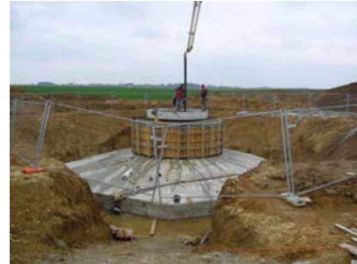
Photographie 12 : Coulage du béton solidarissant la virole, caractéristique des machines de type Vestas, au massif
