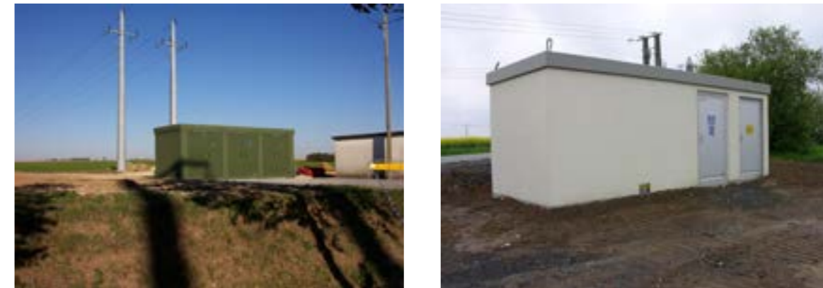
Photographie 1 : Exemples de postes de livraison
