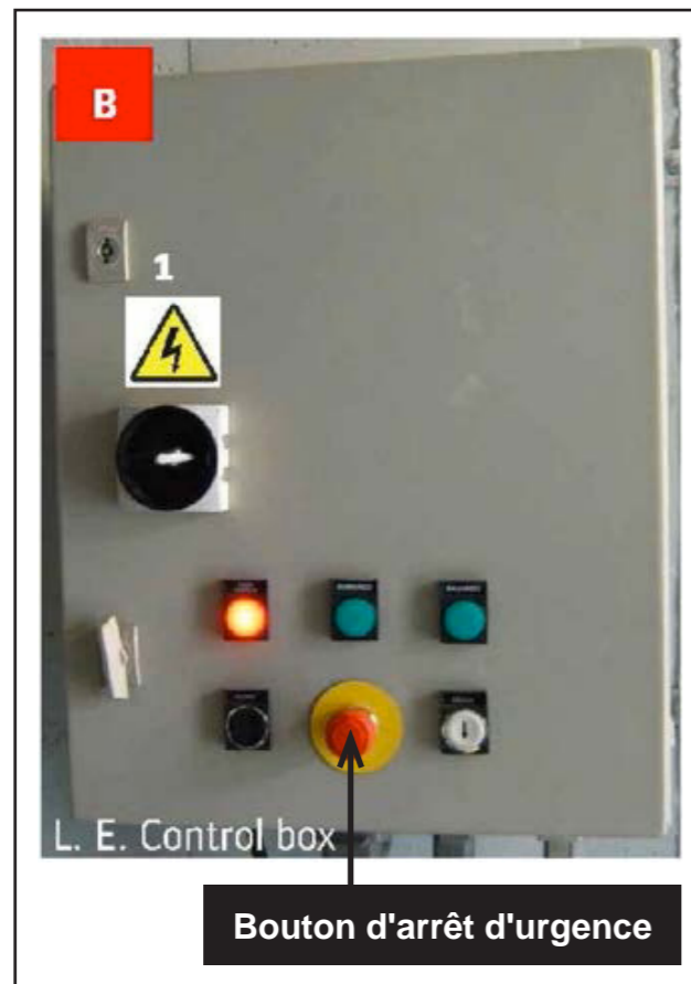
Figure 147 : Bouton d'arrêt d'urgence sur la boîte de contrôle de la nacelle
