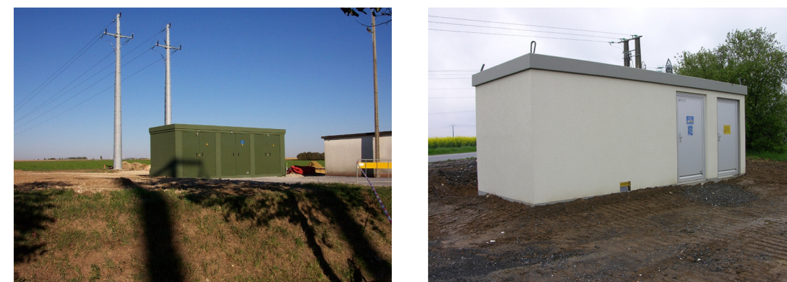
Photographie 1 : Exemples de postes de livraison
