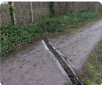
Ici un caniveau transversal évacue les eaux de pluie, Mission Bassin Minier
